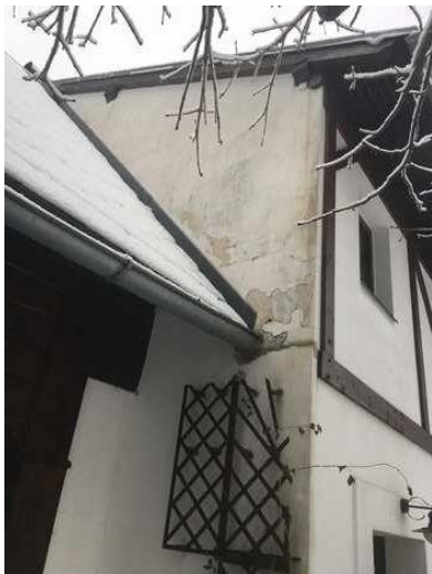
Zatékání u vstupu
