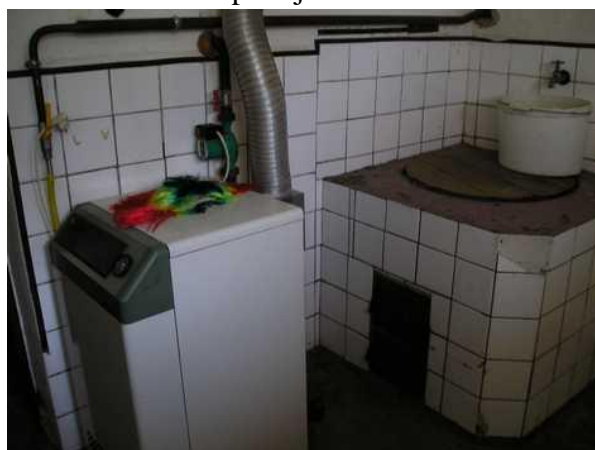
plynový kotel v prádelně
