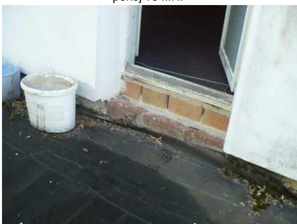
poškozený balkon ve dvoře
