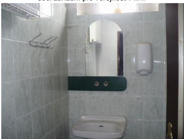
soc. zař. ve II.NP v bytě
