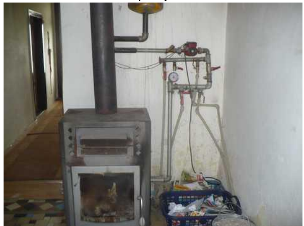
nefunkční kotel ÚT
